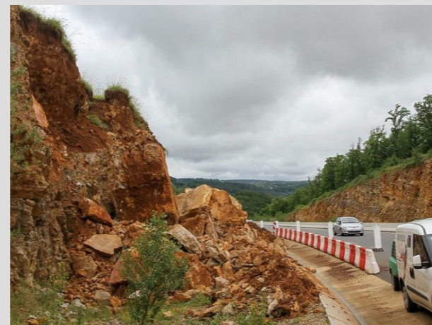
Eboulement déviation de Cambes - juin 2018
