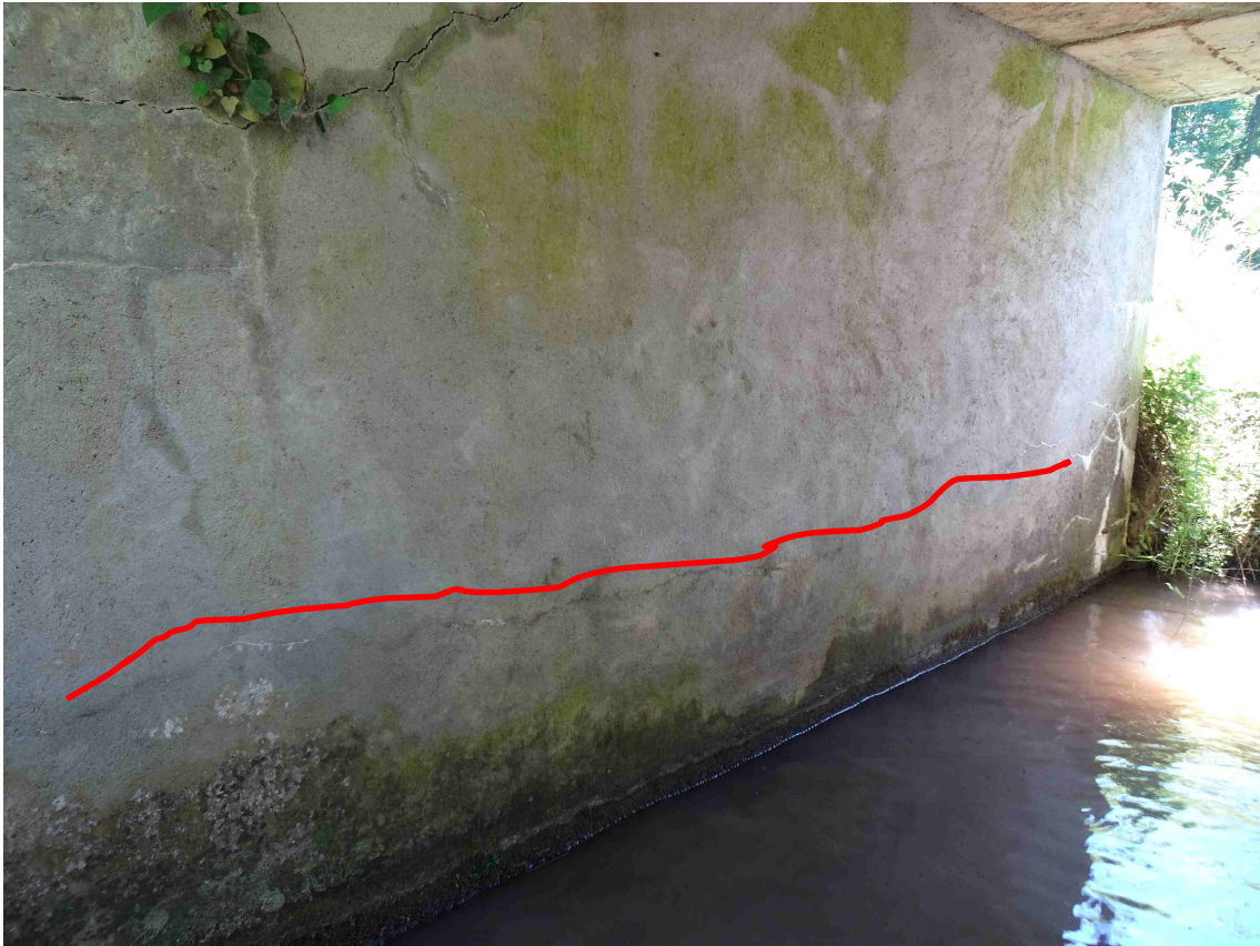
Fine fissure horizontale en partie basse
