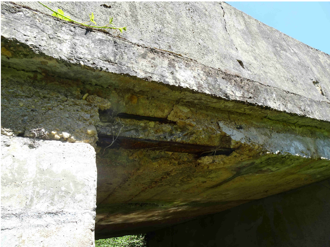
Corrosion des poutrelles métalliques du tablier
