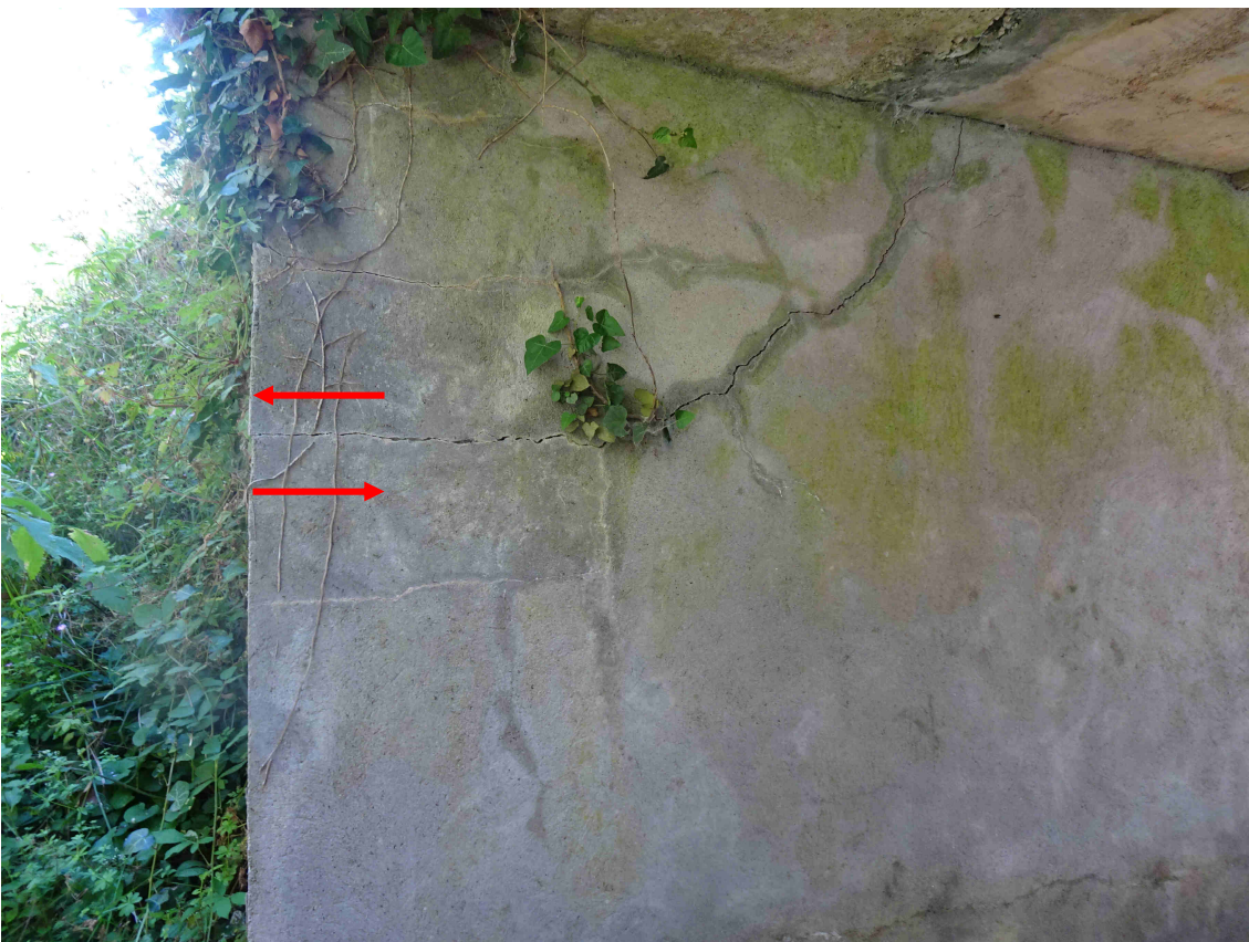
Fracture en arc de cercle et rejet contre la chaîne d'angle
