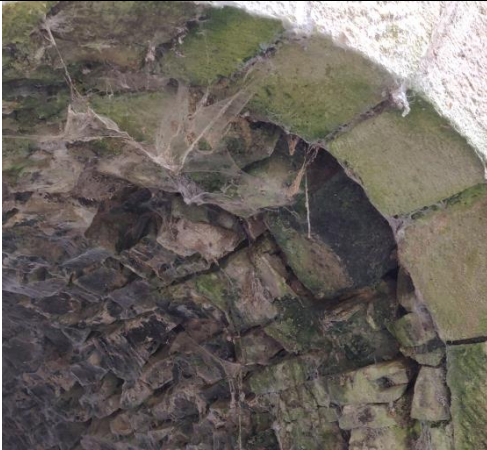
Fissures à réparer du bandeau – Potentiellement favorables aux chiroptères
