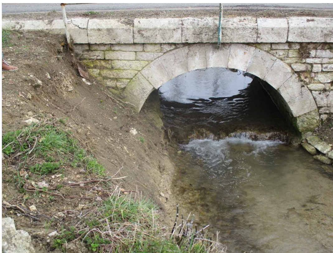
En aval du pont sur la Rive droite, l'enrochement est recouvert de terre
