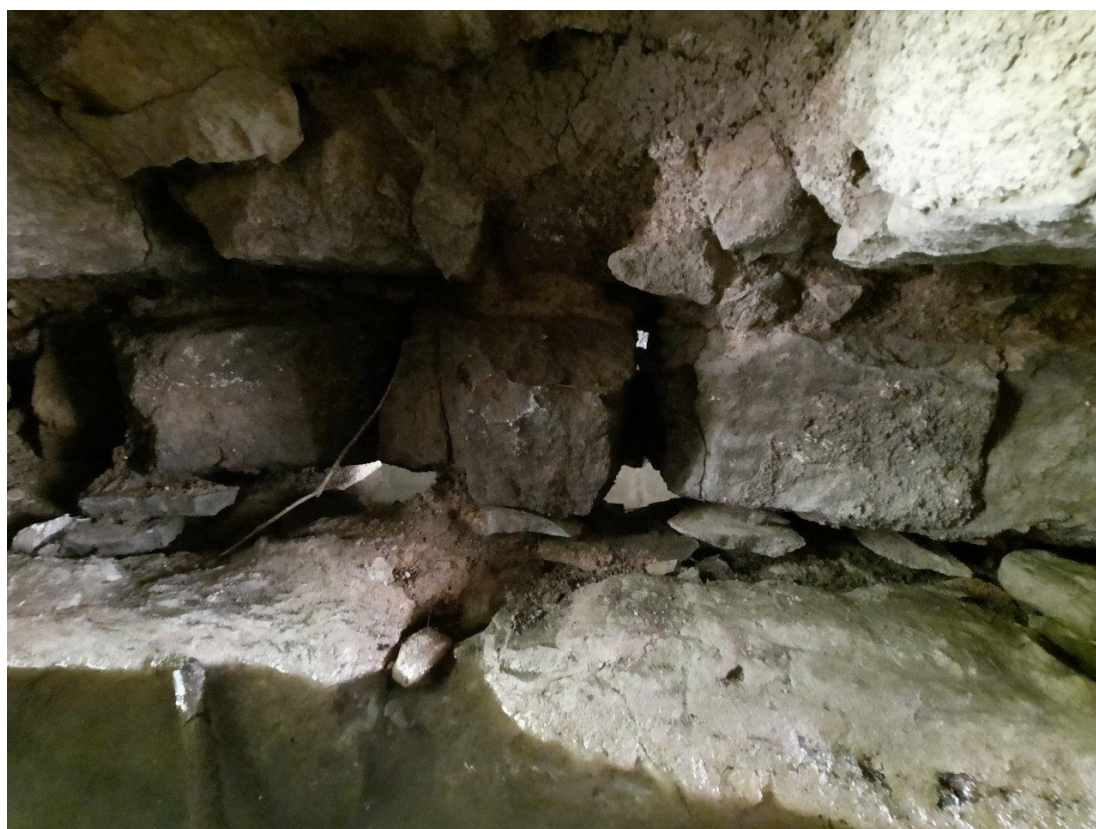
Photo 2 : Sous-cavement des piles du pont de la RD 20, source : Département du Lot
