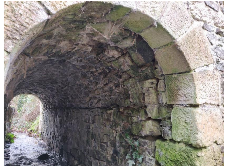
Vue de l'intrados de l'ouvrage et décollement du bandeau amont
