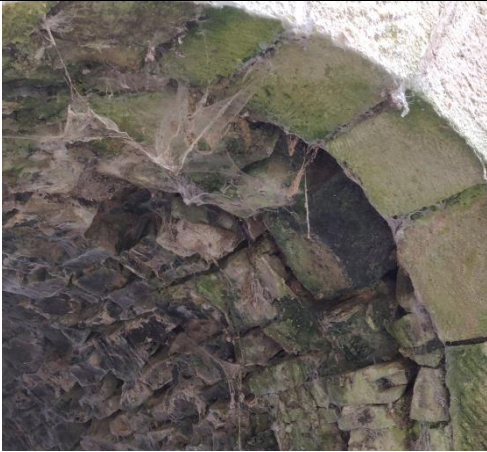
Fissures à réparer du bandeau – Potentiellement favorables aux chiroptères
