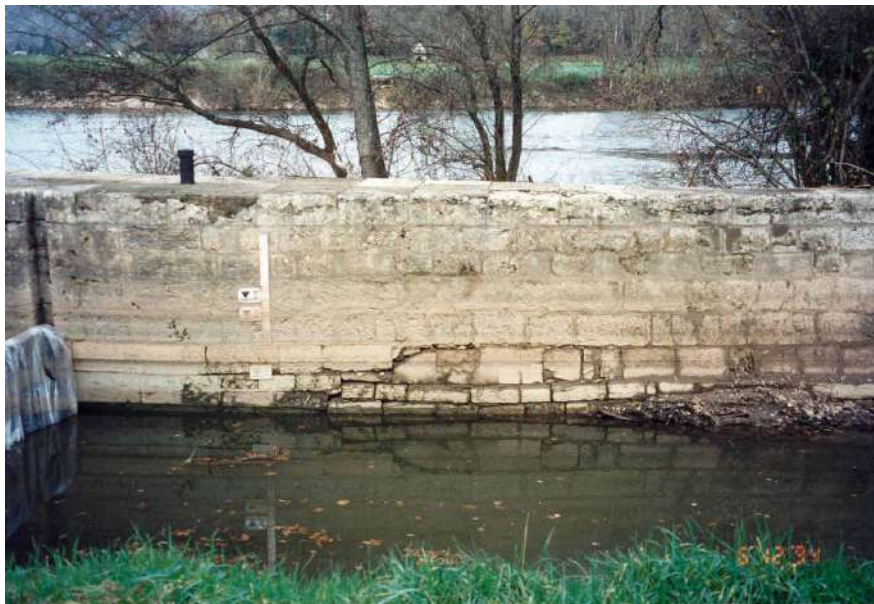
Photo 33 : Fracture à l'amont direct de l'écluse photo 2003- Arcambal (Archive MOA).
