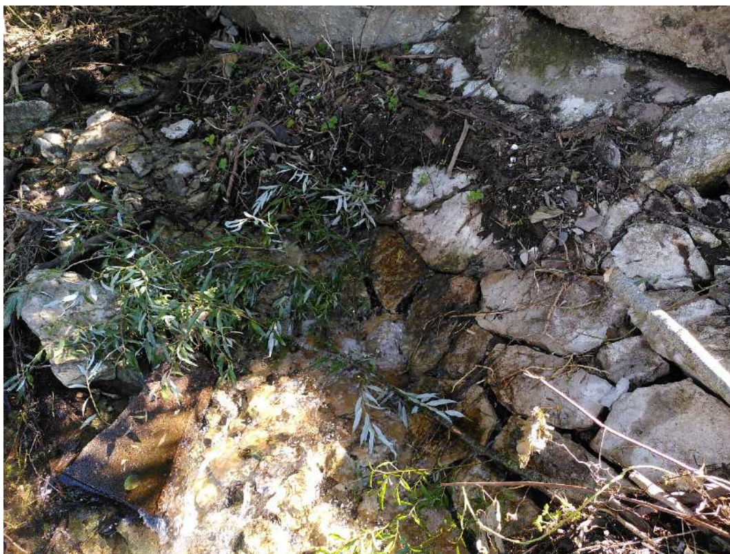
Photo 47 : Venues d'eau à l'arrière du perré maçonné – Arcambal (BIEF).
