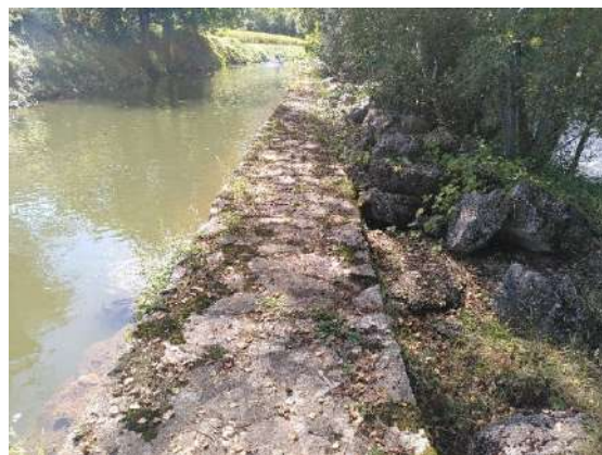
Photo 5 : Apparition de la protection en enrochements côté Lot - Arcambal (BIEF).
