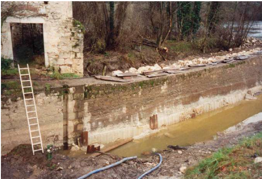
Photo 14 : Renfort du pied de la protection de berge- Arcambal (archive).
