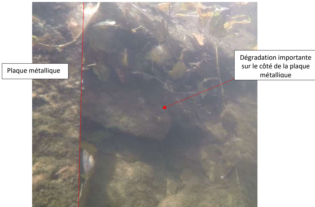
Photo 37 : Extrait de la vidéo générale des plongeurs illustrant les dégradations autour des plaques métalliques (TRAQ).
