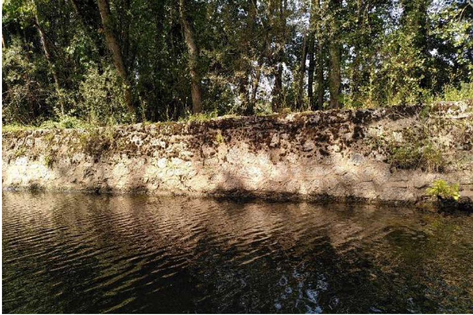
Photo 9 : Vue de la protection de berge sous forme de perré – Arcambal (BIEF).
