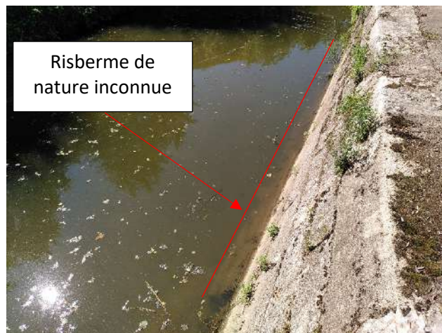
Photo 30 : Ribserme en pied de perré côté canal – Arcambal (BIEF).
