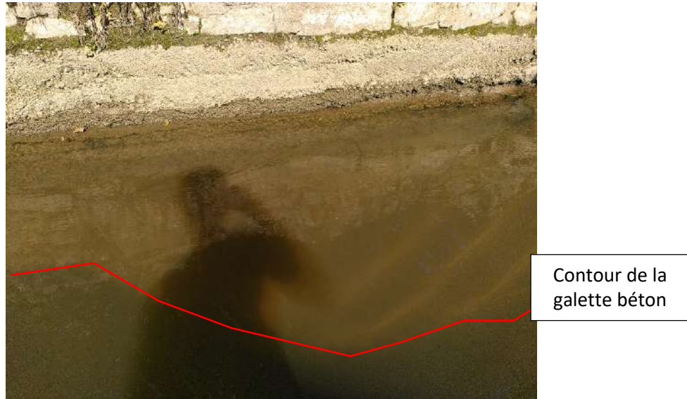
Photo 7 : Galette béton sur la partie amont de la protection de berge – Arcambal (BIEF).
