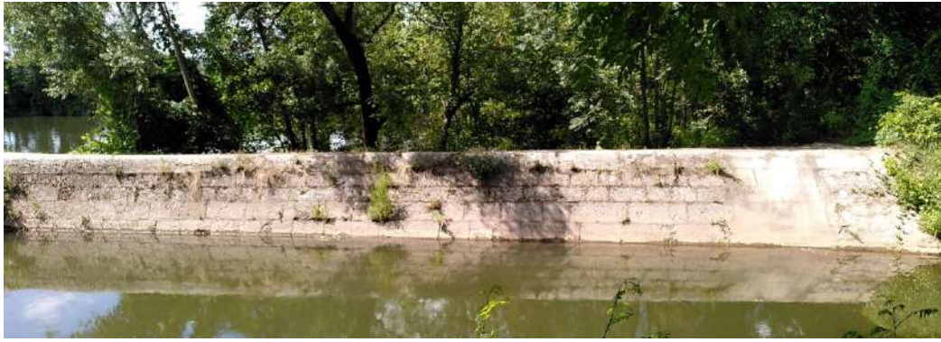
Photo 26 : Façade côté canal de la digue maçonnée en amont de l'écluse – Arcambal (BIEF).
