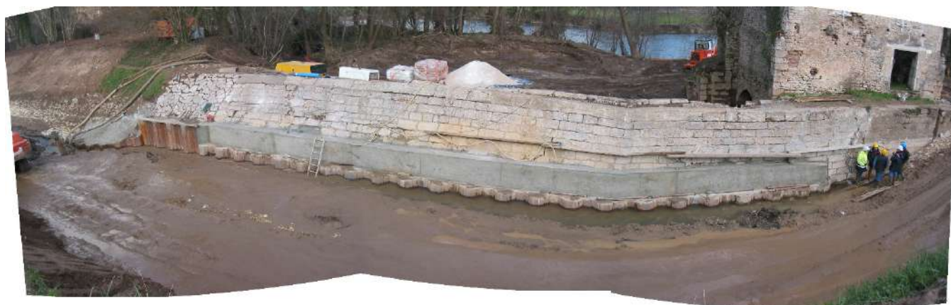
Photo 19 : Renforcement de la digue maçonnée à l'aval du moulin côté canal – Arcambal (Archive MOA).
