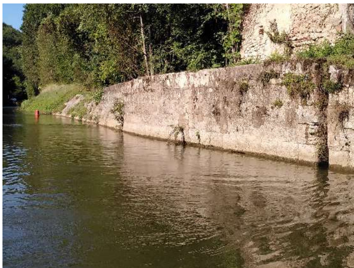
Photo 18 : Évolution du pendage de la digue tronçon n°4 - Arcambal (BIEF).
