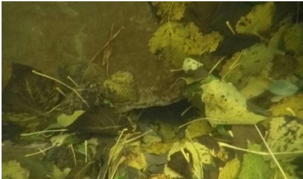
Photo 35 : Joint très dégradé colmaté – Ganil (TRAQ).
