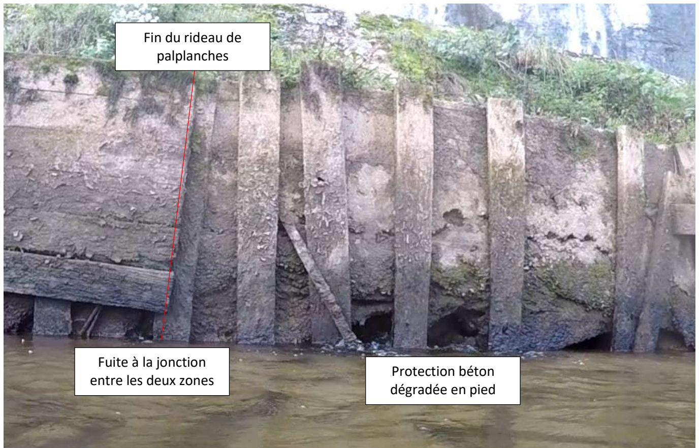
Photo 55 : Jonction entre la protection en palplanches et la protection en béton - Ganil (TRAQ).
