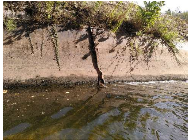
Photo 29 : Exemple de dégradation localisée de la bache – (BIEF).
