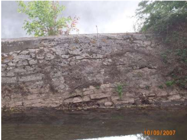
Photo 28 : Vue des maçonneries avant mise en place de la bache d'étanchéité - 2007 - Ganil (Archive MOA).
