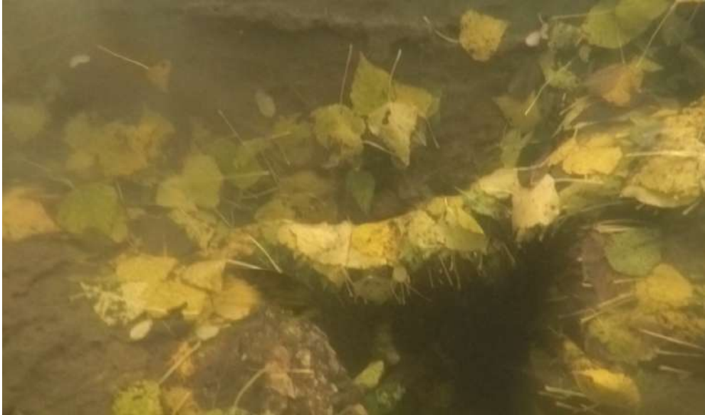
Photo 40 : Dégradation à la jonction TN / Bajoyer - Ganil (TRAQ).
