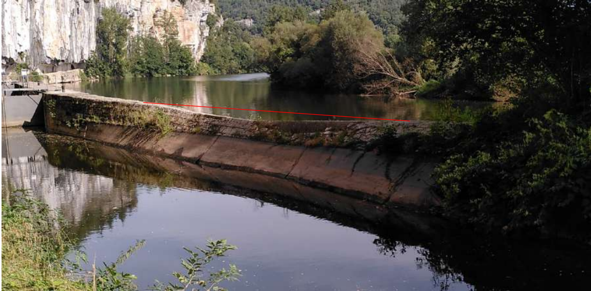
Photo 22 : Défaut d'horizontalité de la crête du guideau – (BIEF).
