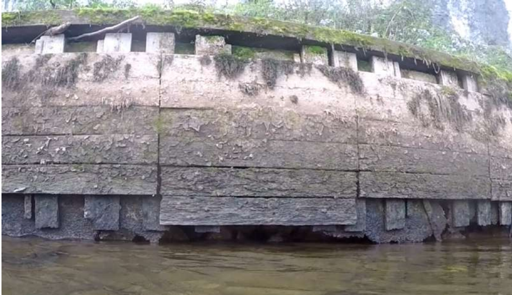
Photo 56 : Dégradation de la protection de risberme en béton – Ganil (TRAQ).
