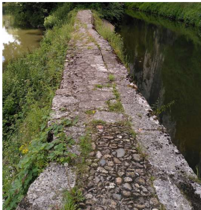
Photo 41 : Déformation du guideau depuis la crête.- Ganil (BIEF).
