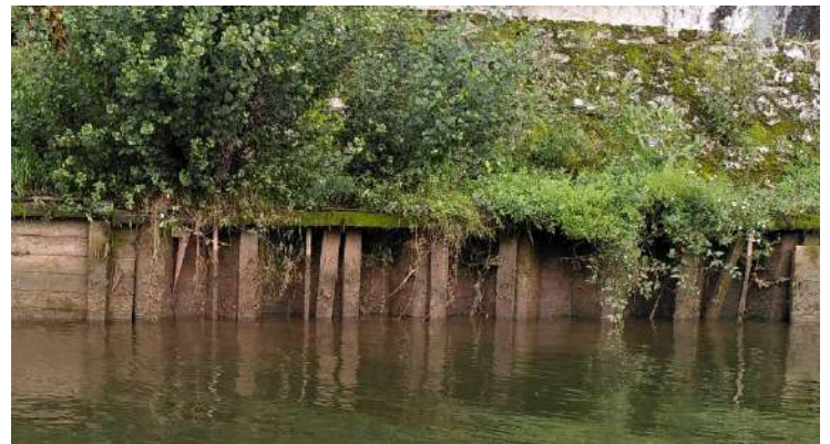
Photos 44 et 45 : Fracture et décollement au niveau de la crête de l'ouvrage – Ganil (BIEF).
