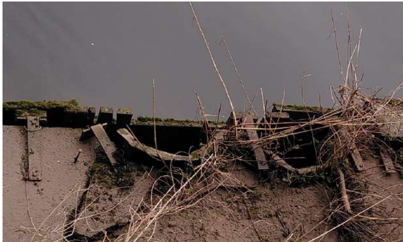
Photo 63 : Stigmates sur les palplanches témoignant d'un surbattage (BIEF).
