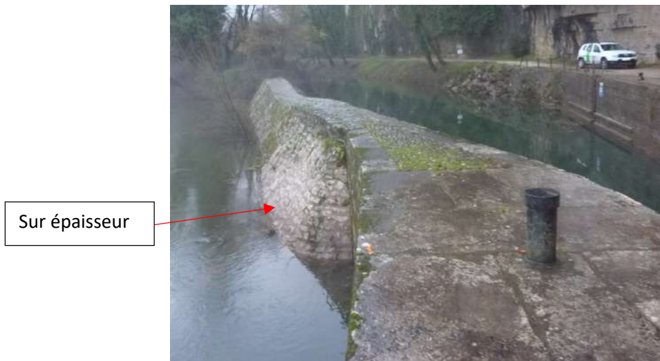
Photo 18 : Sur-épaisseur au niveau de l'arrière du guideau - Ganil (Archive MOA).
