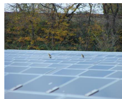
Avifaune présente sur une centrale photovoltaïque
