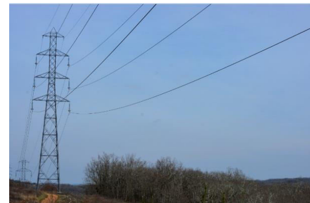
(5) Ligne haute tension traversant l'aire d'étude
