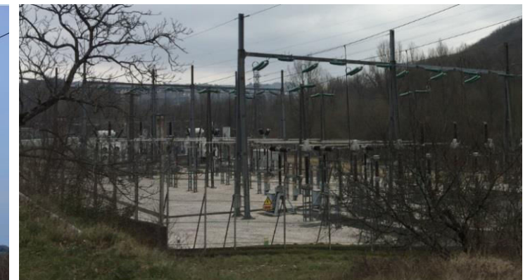
Poste électrique de Ferouge en contrebas du site
