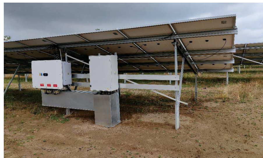
Exemple de mise en place des onduleurs sur les structures – source EnergieKontor
