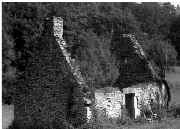
Frayssinet-le-Gélat, maison en ruine.
